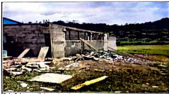
Foto 5: Las condiciones de aulas antes de los trabajos estaban en mal estado, se tuvo al necesidad de hacer cambios de fondo en la estructura de los mismos.
